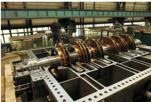
Vzduchový kompresor 7 RMB 122 o výkonu 228000 m 3 h -1 s tlakem na výtlaku 0,714 MPa s pohonem parní turbinou 25 MW pro dodávku vzduchu pro kyslíkárnu
