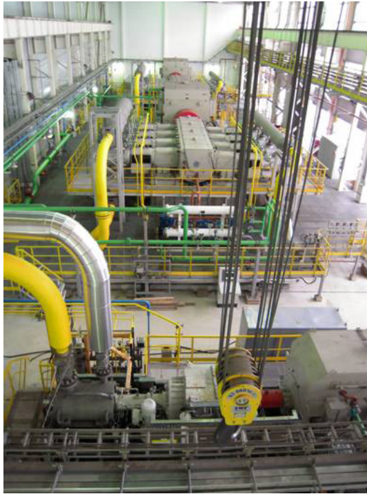
Strojovna s kompresory ČKD v rafinerii KINEF v jednotce hlubokého zpracování ropy. V popředí odstředivý barelový kompresor 7 RSA 39 stlačující vodíkový plyn s tlakem 9,1 MPa s regulací otáček pomocí hydrodynamické převodovky. V pozadí dva 8 válcové boxerové kompresory ČKD typu 8 DBK 460 BP na vodík s tlakem 8,24 MPa
