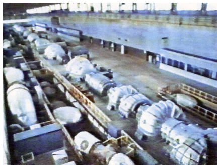
Pohled do strojovny u zákazníka, kde zařízení vyrobená v ČKD slouží pro kosmický i letecký výzkum. R. 1985
