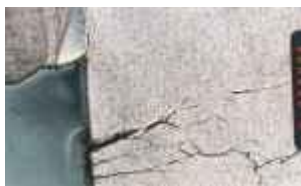
Detail korozní trhliny
